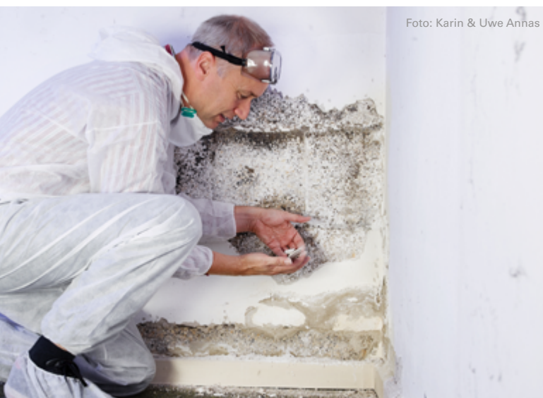
Schimmel im Gebäude.
